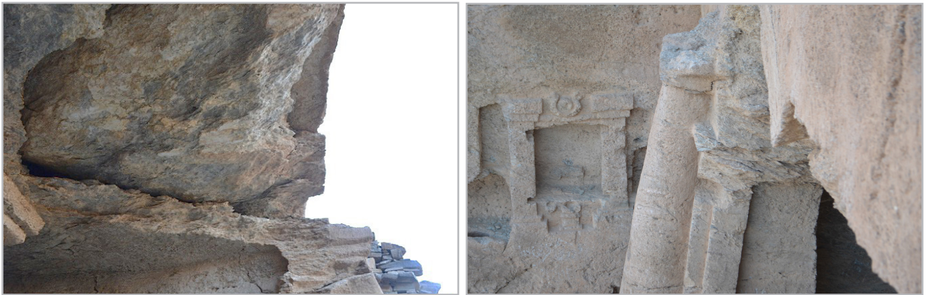
Figura 6.- Izquierda: ámbito del desprendimiento del techo del frontispicio (que trabaja como voladizo). Derecha: Proceso de abrasión (erosión eólica) en las zonas más expuestas de la fachada y en los elementos salientes, donde el impacto de las partículas trasportadas por el viento es más virulento.
